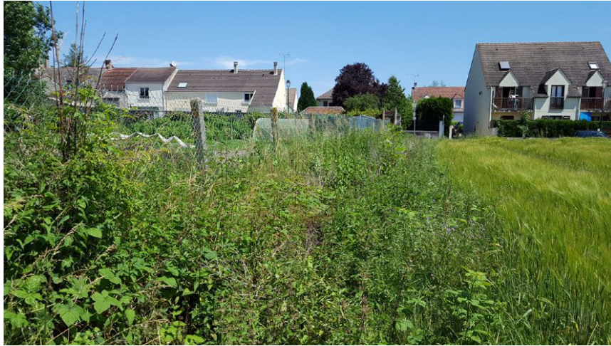
Aperçu du fossé dans sa partie basse avant l'arrivée sur la route, la végétation masque la profondeur du fossé
